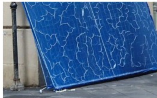
Uno dei pannelli luminosi installati (foto Figli delle Chiancarelle)
