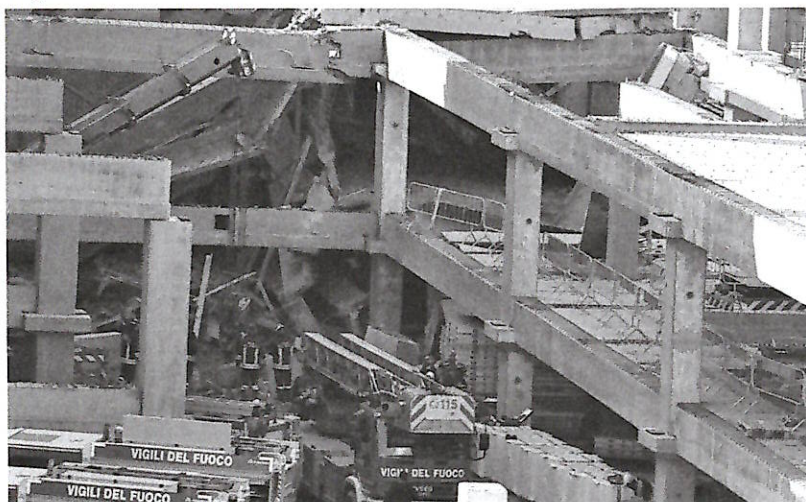
Il crollo nel cantiere dell'Esselunga in costruzione a Firenze provocò cinque morti il 16 febbraio 2024
