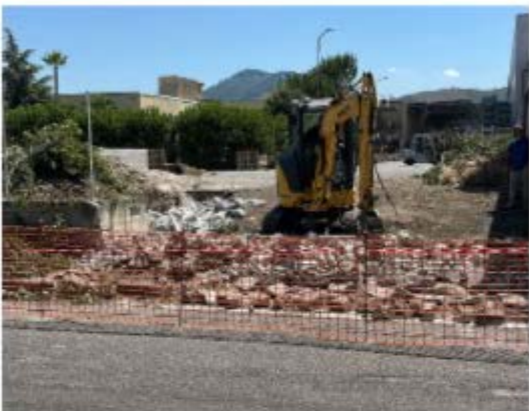
Il muro abbattuto in via Modigliani
