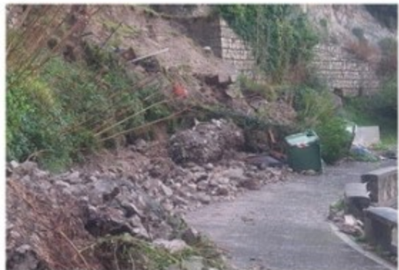
La recente frana registratasi in località Fuenti a Cetara
