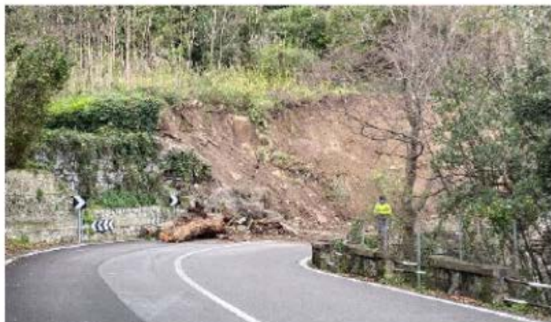
La zona della Statale Amalfitana in cui si è verificato l'ennesimo smottamento
