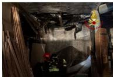
Falegnameria devastata da fango e detriti a Pellezzano
