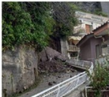
I detriti che hanno invaso le abitazioni a Marina di Vietri sul Mare
