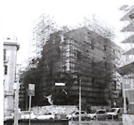
▲ Pericolo La struttura transennata di via Amato di Montecassino e salita Porteria San Raffaele
