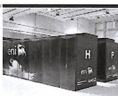
Data center Il supercomputer dell'Eni
