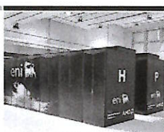
Data center Il supercomputer dell'Eni
