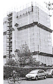
Un cantiere del Superbonus 110, dopo l'esplosione dei costi il governo è tornato agli incentivi classici del 50%
