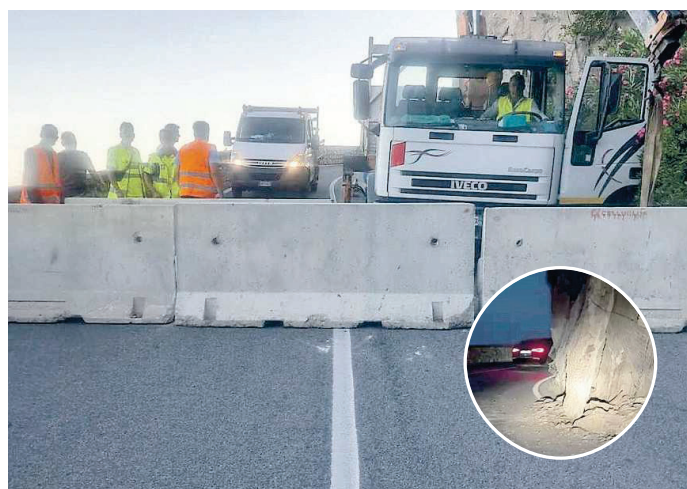
BLOCCO E VERIFICHE Per motivi di sicurezza l'arteria è stata chiusa al traffico: l'obiettivo è ripristinare le condizioni di viabilità ordinaria sull'Amalfitana. A lato, verifiche in corso
