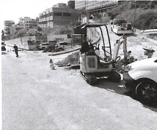
Cantiere interessato da un incidente
