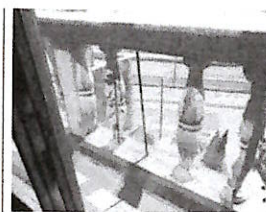
▲ Il degrado Balcone abbandonato
