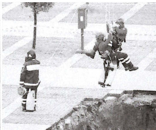
▲ L'intervento Vigili del fuoco si calano dentro la maxi voragine
