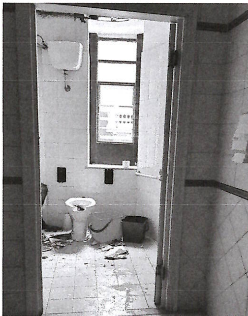
Crolla parte di soffitto
